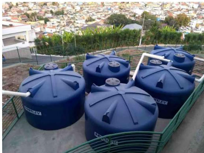
Figure 12: Três Corações Campus rainwater reservoir tanks.
